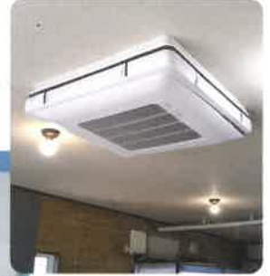
新設の業務用エアコン。 涼しい！省エネ！ ワンコたちも大喜びです。
