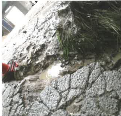
ガレージから施設前を通る道は崩落しました。
